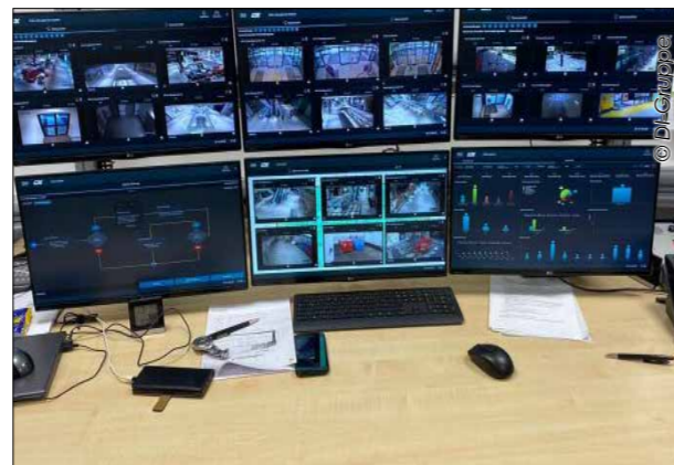
Videoüberwachungsraum mit Frequenzzählanlage und direktem Kontakt zum Sicherheitspersonal
